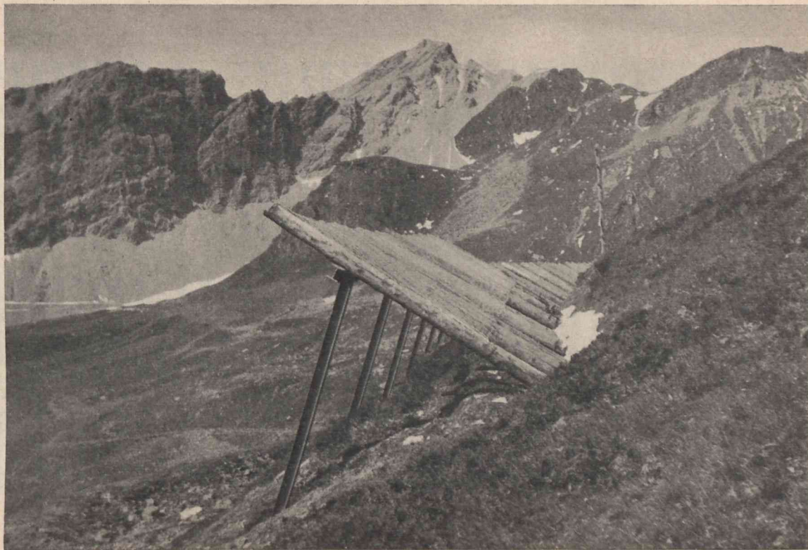
Lawinenverbauung Dorfberg-Davos: Schneerechen
